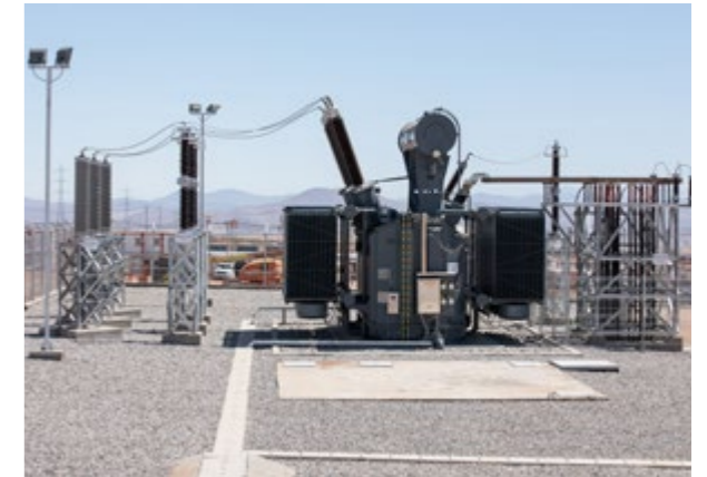
▲ 230MVA-220kV Transformer El Romero Substation Chile
